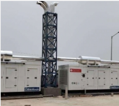
Walmart Project 500 kVA x 3
